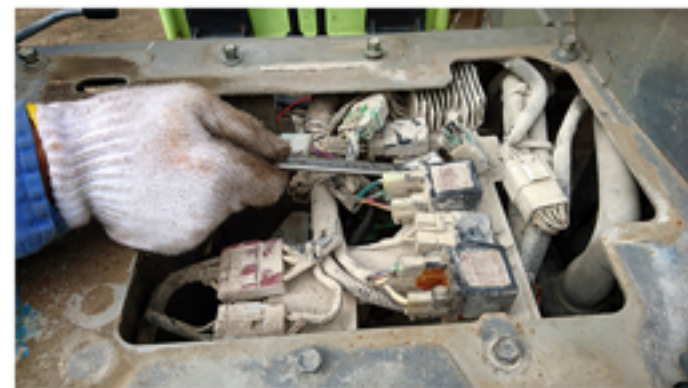
細かい粉塵が車体内部を侵蝕
